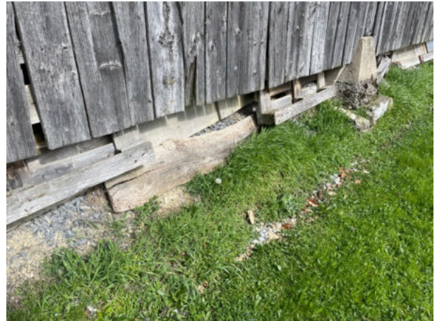
Abb. 14: Alte Scheune mit Spalten in Bodennähe im Mauerwerk und Holzelementen.
