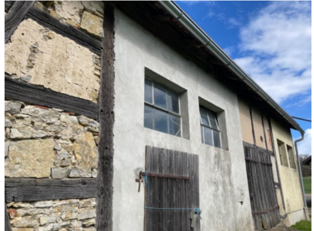
Abb. 12: Alte Scheune mit Spalten im Mauerwerk und Holzelementen.
