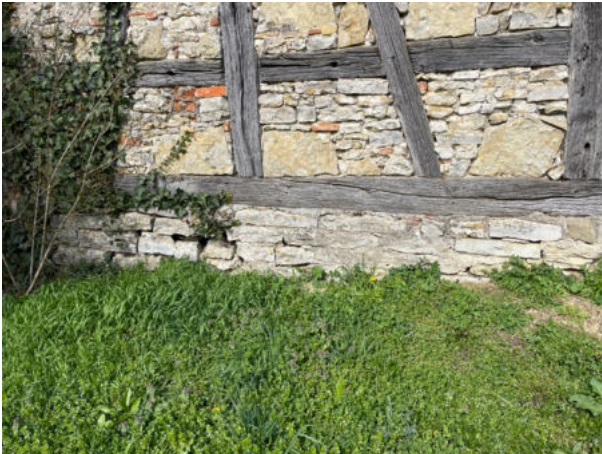
Abb. 13: Alte Scheune mit Spalten im Mauerwerk und Holzelementen.
